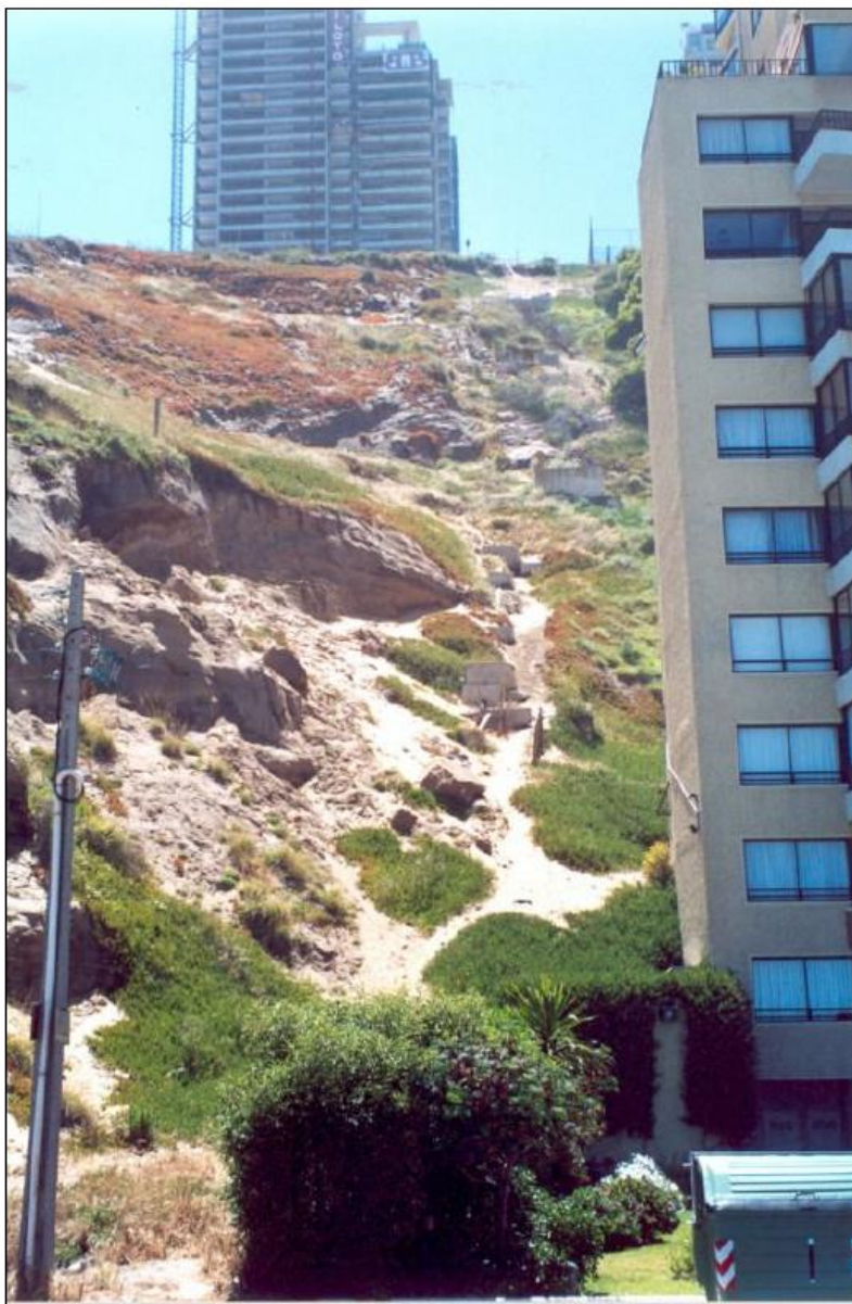
FIGURA N° 5-1 Talud costero en camino Reñaca-Concón en que se observa caída de bloques de roca y deslizamientos de arena.
